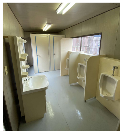
※ユニットハウス内へ設置
