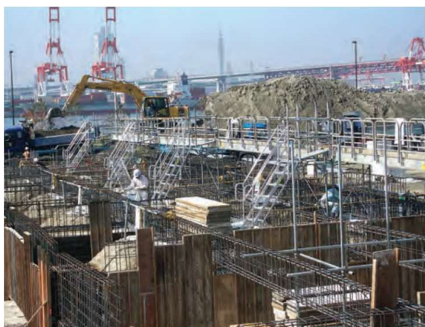
安全通路よりピットへの昇降設備
